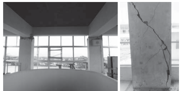
a. 柱と窓枠損傷
