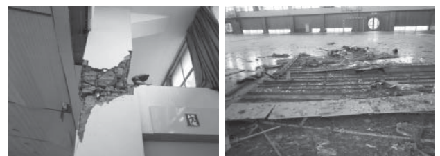
c. 柱の損壊
